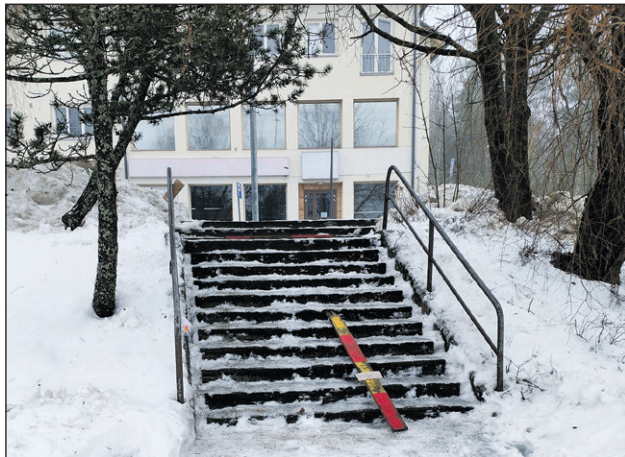
Kenen hoitovastuulla on nämä portaat? Ei kunnossapitoa?
